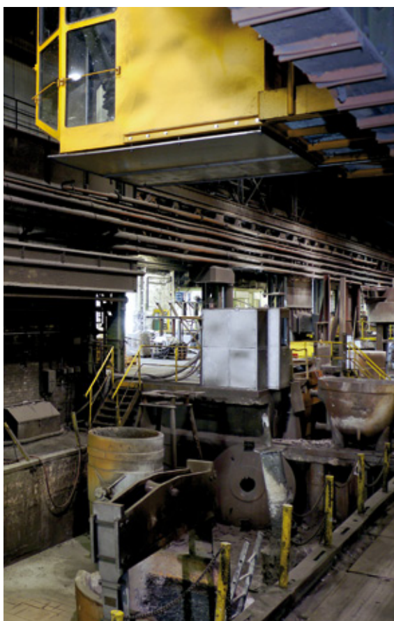
In der Steuerkabine (oben rechts) sieht der Kranführer alle Temperaturen der relevanten Pfannen
