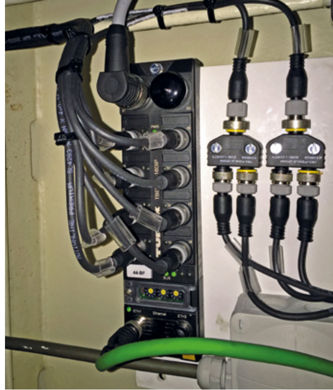
Schaltkästen und andere Schutzvorrichtungen sind mit Turcks robusten Block-I/O-Lösungen in IP69K nicht mehr erforderlich
