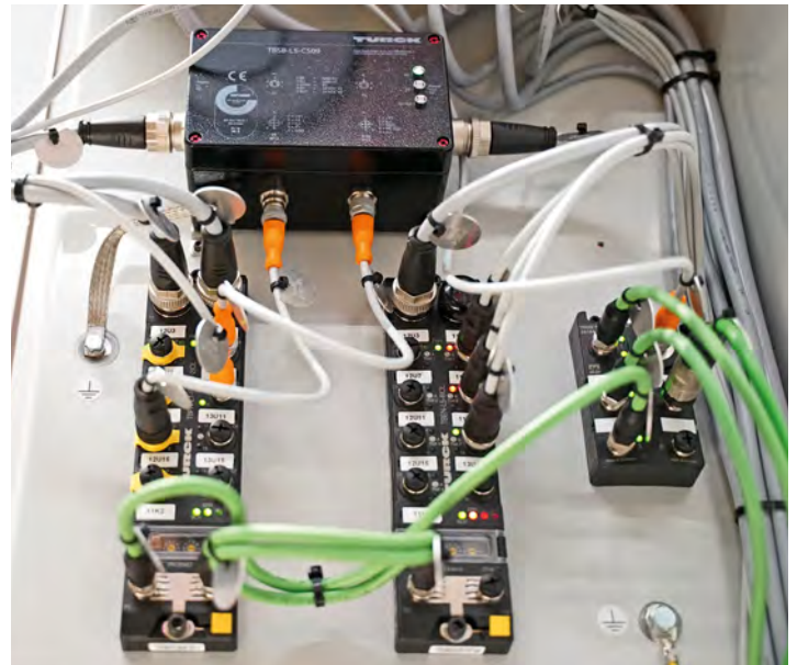
Diese Sicherheitsapplikation wird zum Testen im Werk über das TBPN (links) gesteuert. Im Live-Betrieb beim Endkunden übernimmt dann eine Profisafe-Steuerung die Applikation. Alle Aktoren, die am IO-Link-Master (Mitte) hängen, werden über die TBSB-Box (oben) sicher abgeschaltet
