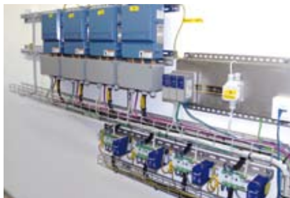
Da die integrierten Power Conditioner der Rosemount-Schnittstellen (o. I.) nicht stark genug waren, versorgen jetzt externe Turck Power Conditioner die FF-Segmente
