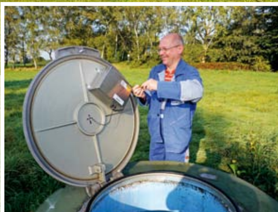
Turck lieferte vorkonfektionierte Systeme im Edelstahl-Schaltkasten, die RWW-Elektriker Klaus Bitter nur noch am Brunnendeckel montieren musste
