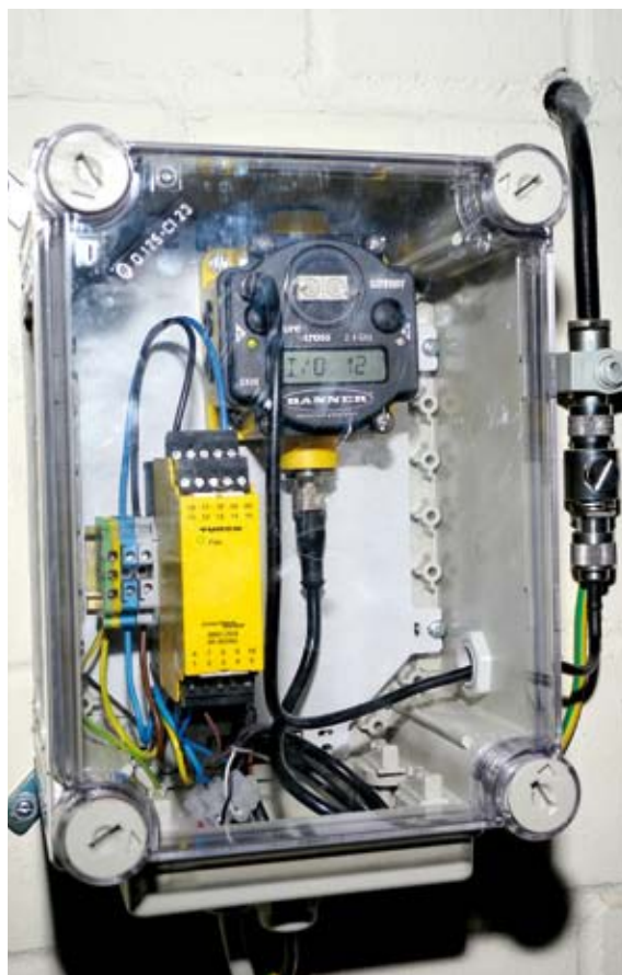
Das DX80-Gateway verarbeitet die Funksignale und leitet sie per Modbus-RTU an die Warte vor Ort und die zentrale Leitwarte weiter
