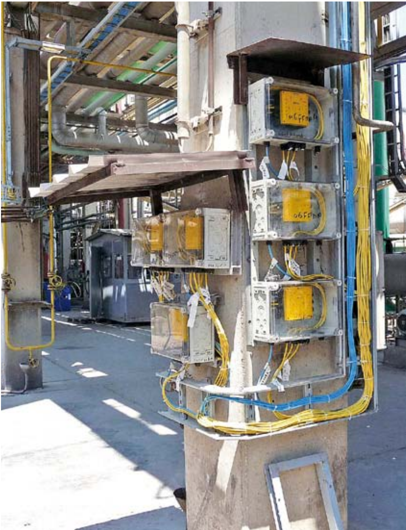
Aufgrund der besonderen Umgebungsverhältnisse in der Ammonikanlage wurden dort alle IP67-Feldbuskomponenten zusätzlich eingehaust
