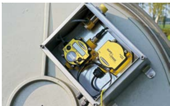
Die IP67-Komponenten der DX80-Anlage samt Sensor sind in einem Schaltkasten installiert
