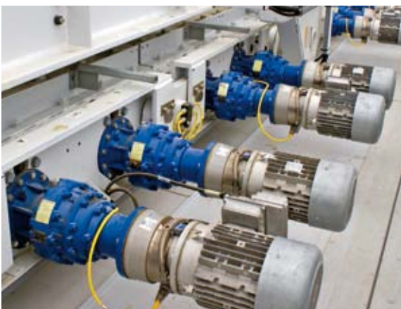
Für den Anschluss von Umrichtern und Motoren nutzt Uni-Systems kundenspezifische, geschirmte Kabel von Turck
