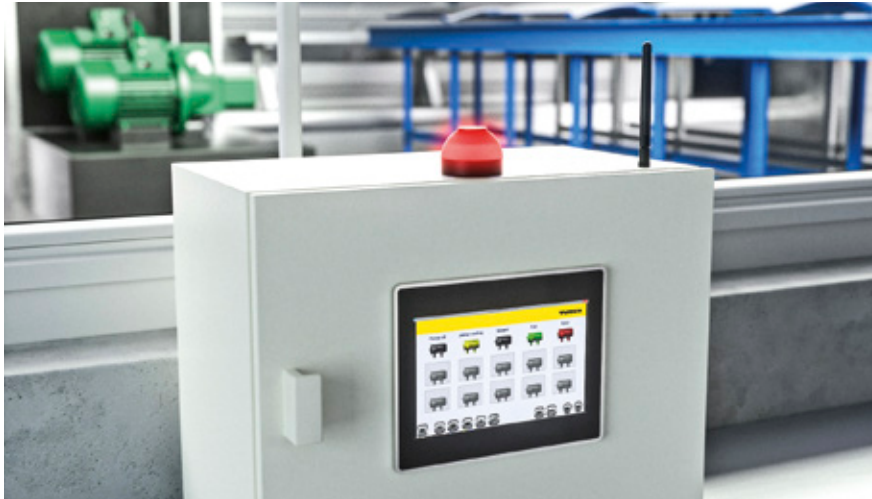
Der Anwender hat auch direkt vor Ort alles im Blick mit der Datenvisualisierung auf dem TX700 HMI/PLC
