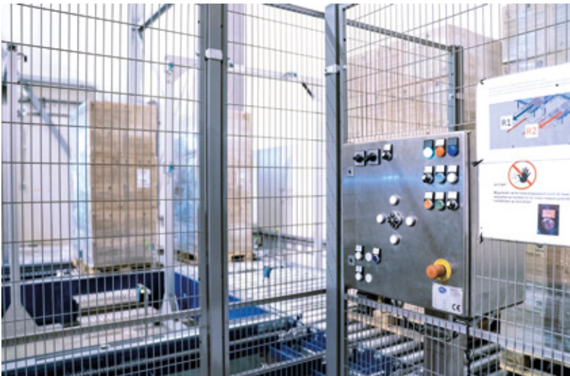
Zwei Schaltkästen dienen der manuellen Kontrolle, im Inneren erweitern FEN20-Multiprotokoll-Module das Angebot an Ein- und Ausgängen
