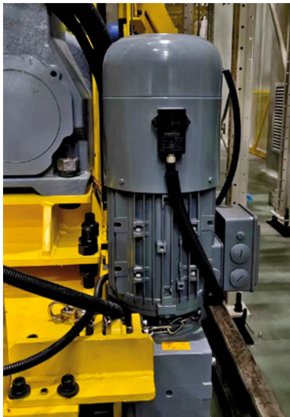
Für jeden Stapelkran werden drei CMVT-Sensoren verwendet, jeweils einer für jeden Motor
