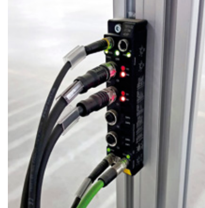
Turcks TBEN-S-Module sichern die Kommunikation zwischen den PTL110 und dem WMS
