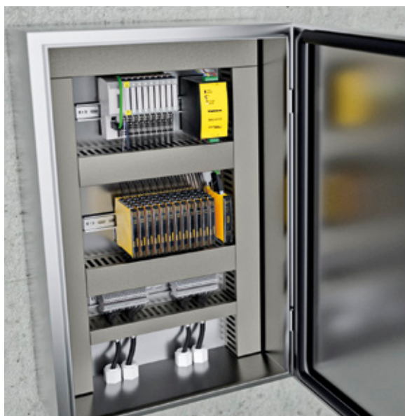
Die vom CCM-Schaltschrankwächter erfassten Daten erlauben vorausschauende Wartung und steigern so wdie Verfügbarkeit
