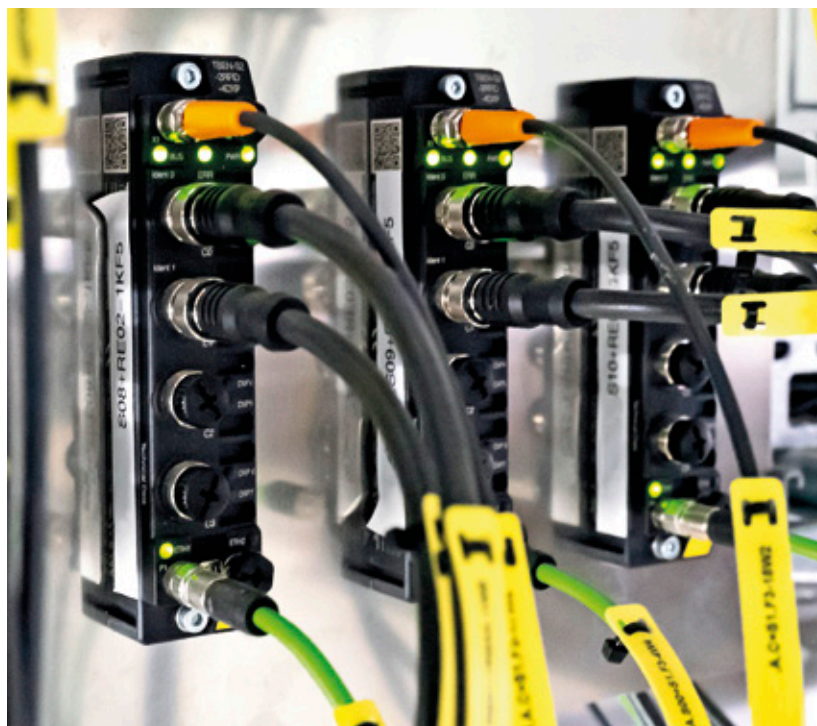
Turcks RFID-Interfaces TBEN in IP67-Ausführung werden ohne Schaltschrank im Lager auf einer Metalltafel verschraubt
