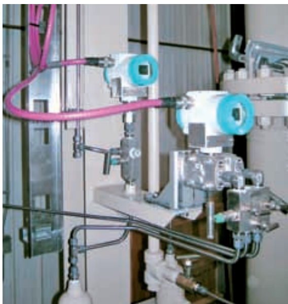
Die Transmitter sind über extrem robuste Kabel mit Metallmantel mit den Verteilerboxen verbunden
