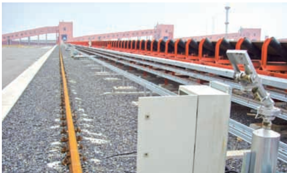
An jedem Sprinkler ist ein Schaltschrank mit einer BL20-Station installiert
