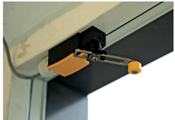
Unsichere Türkontakte oder aufwendig zu montierende Rollenschalter kamen für die Nachrüstung der Schaltschranküberwachung nicht in Frage
