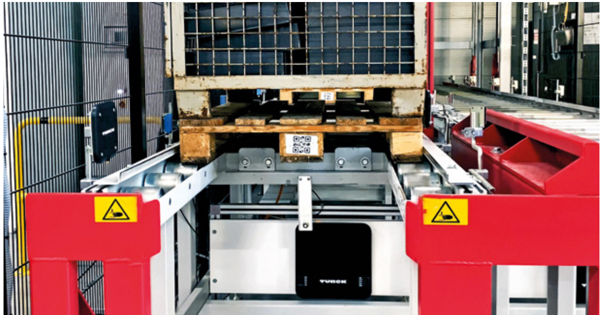
Am Fördersystem erfassen externe RFID-Nahfeldantennen ausschließlich die unmittelbar vor ihnen befindliche Palette
